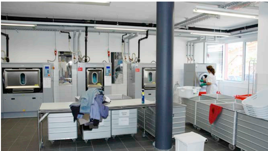
In die Planung wurden Platzreserven für eine Erweiterung integriert. Reine und unreine Seite sind getrennt die drei 50-Kilogramm Durchlademaschinen verfügen über Trennwandtechnik, eine vierte kann jederzeit integriert werden. Mit den Blick durch die Glasscheiben kann eine Mitarbeiterin auch die Maschinen der reinen Seite überwachen.
